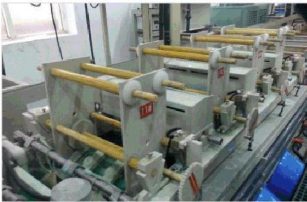
镀金属镍 (Ni) 自动生产线 Metallized Nickel Automatic Production Line
